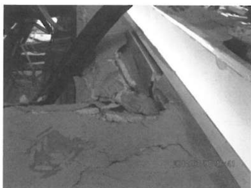
写真 A：割れている天板の石膏
